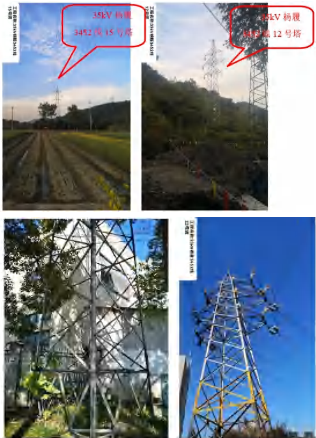
35kV 杨履 3452 线部分角钢塔掉漆、腐蚀严重现状
