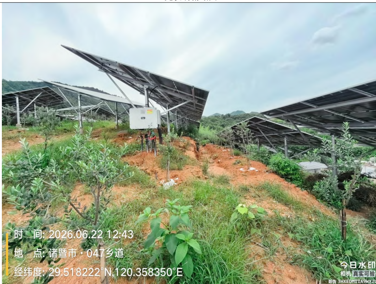
光伏场、逆变器
