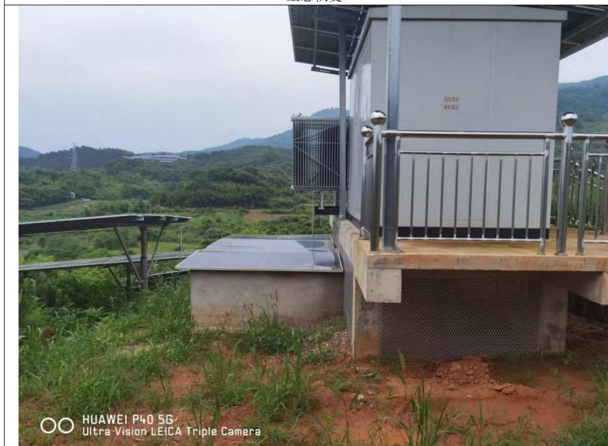
变压器及应急油池
