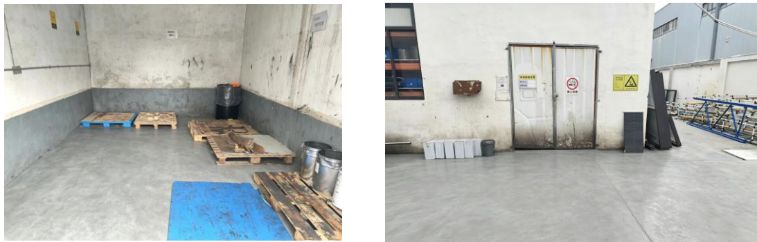
图 3-2 现有危废暂存间
